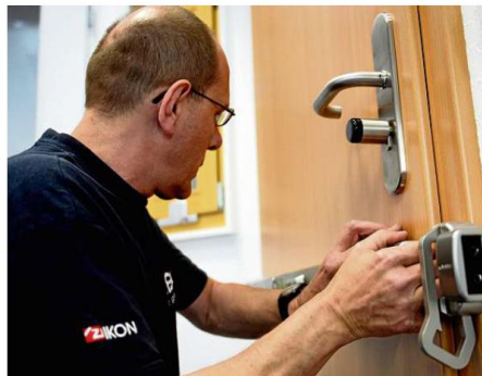
Es muss nicht immer neu sein: Mit zusätzlichen Installationen kann die Sicherheit auch erhöht werden.
